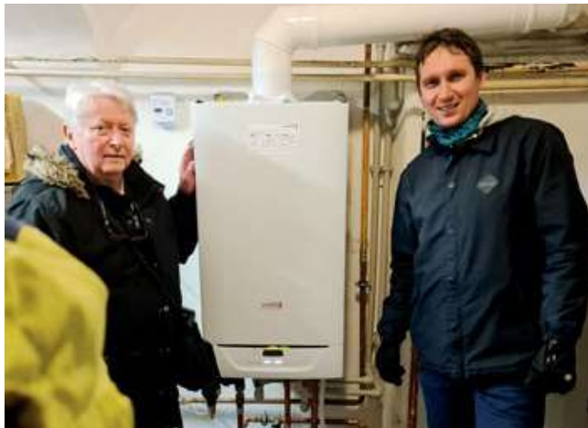
Spokojený majitel nového plynového kotle pan František Synek (vlevo) s kotlíkovým specialistou Jindřichem Gabrielem
